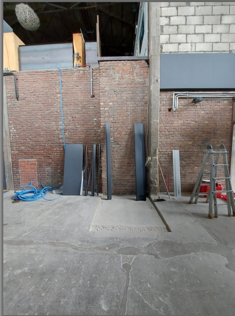
Vergrößerte Schachtgrube mit nur 60mm tiefe
